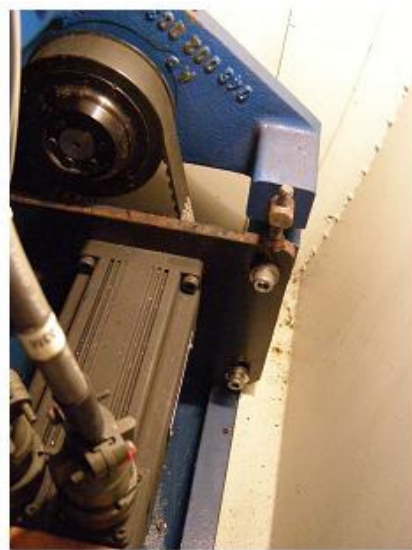
Servomotor do carro longitudinal
